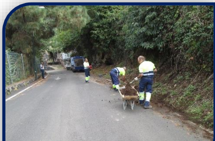
Retirada de tierras transportadas por el agua a causa de las lluvias
